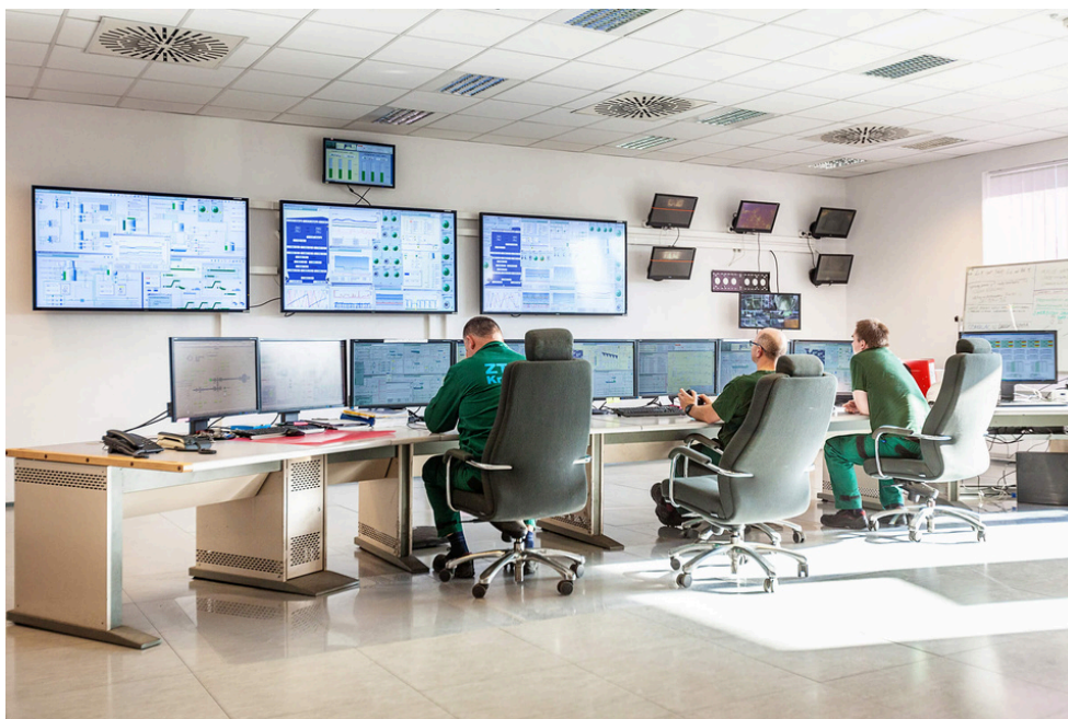
Gracias a la solución Insignia de Adasa, los operadores de la sala de control invierten su tiempo a planificar, supervisar y vigilar normas y procesos
